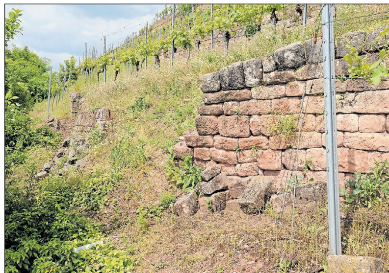
Wie hier sind vor drei Jahren in den Weinbergen der Familie Kusterer fünf Trockenmauern gleichzeitig eingestürzt.
