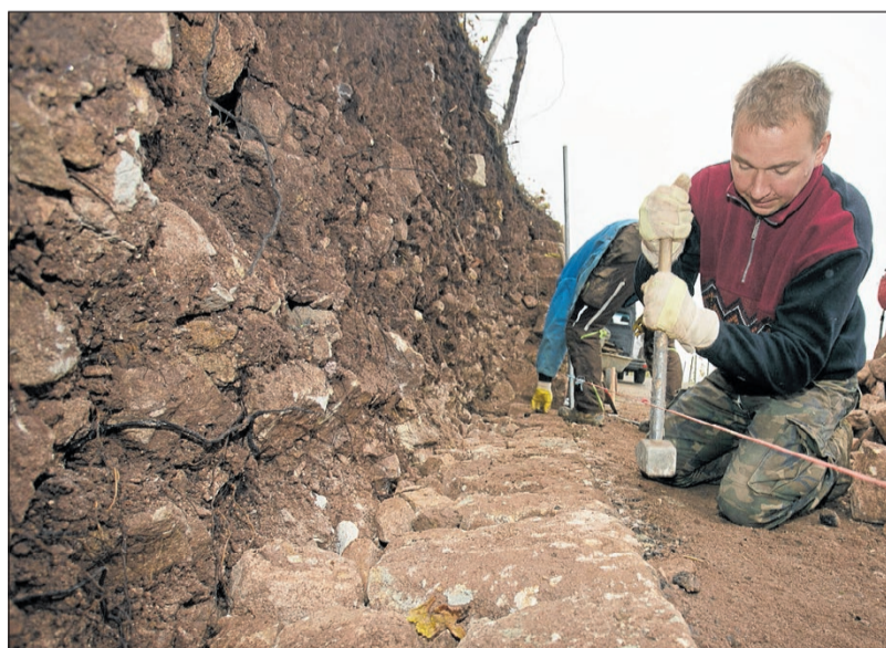
Auf die richtige Grundlage kommt es an: Weinbau-Mitarbeiter Pawel Jaworski hat schon daheim in Polen gelernt, wie man Trockenmauern richtig aufbaut.
