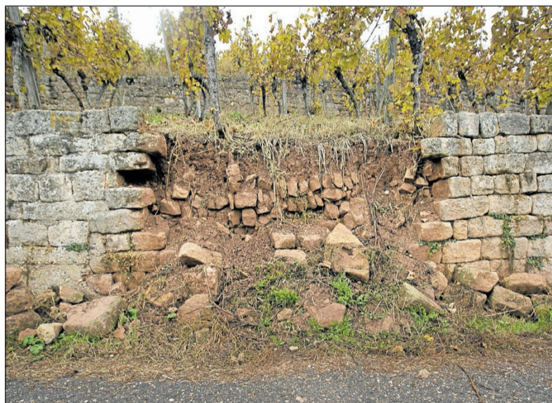
Der Hang kann ganz schön Druck machen: Gerade bei sehr nasser Witterung drohen Trockenmauern einzustürzen. Dann muss rasch Hand angelegt werden.
